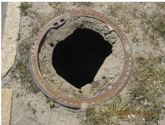
Uszkodzony właz studzienki ul. Sikorskiego
