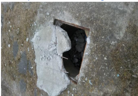
Uszkodzony właz studzienki ul. Chmielna
