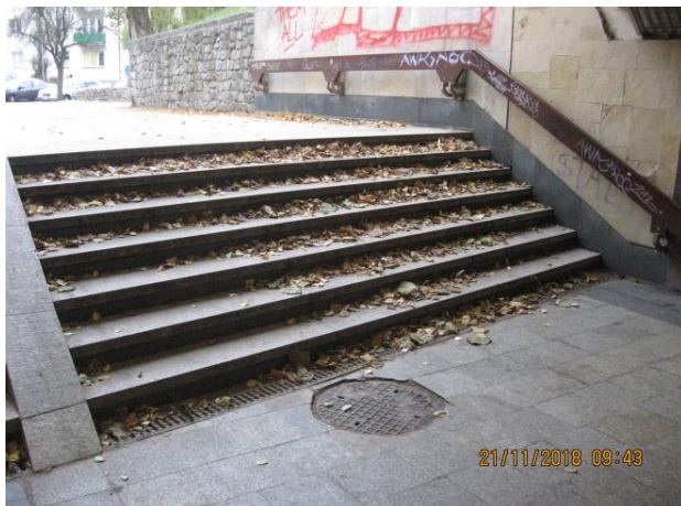
Zanieczyszczone liśćmi schody przejścia
