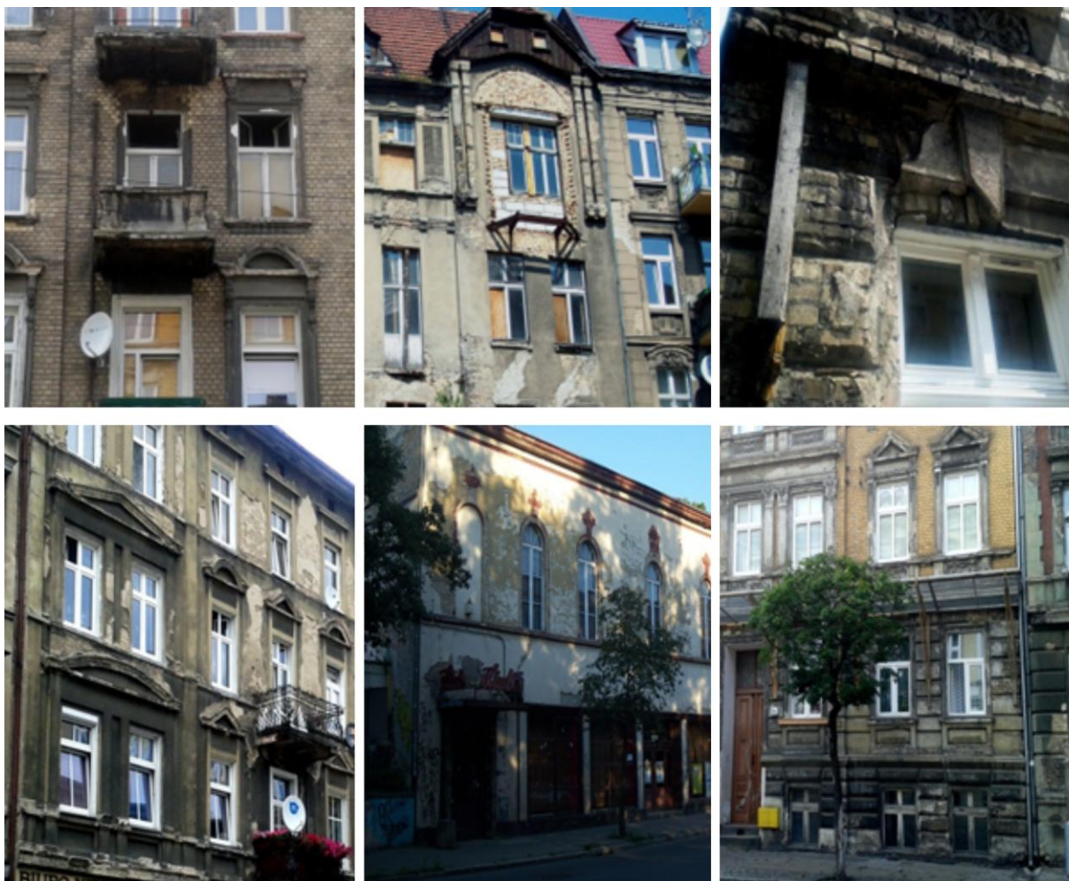
Rysunek 27. Stan techniczny przykładowych budynków w obszarze rewitalizacji.
