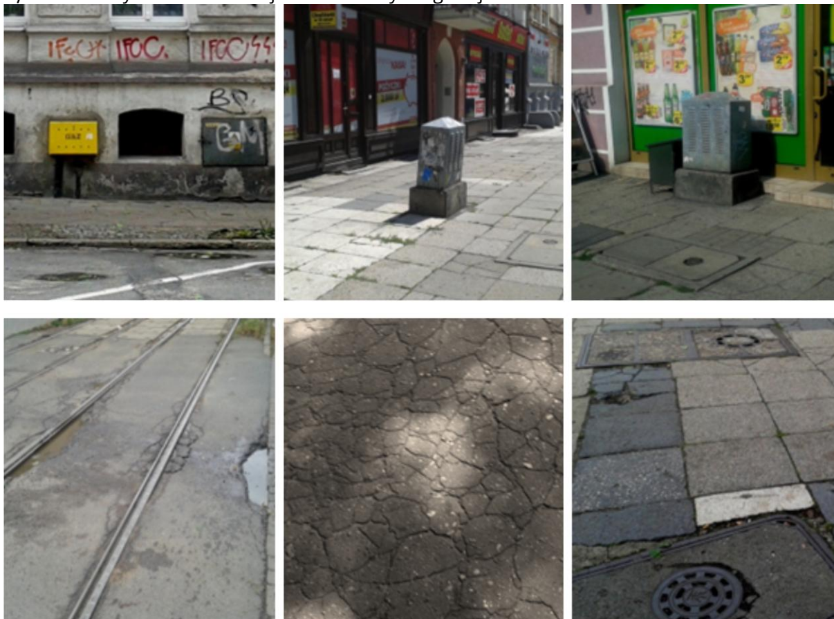
Rysunek 20. Zły stan technicznej infrastruktury drogowej
